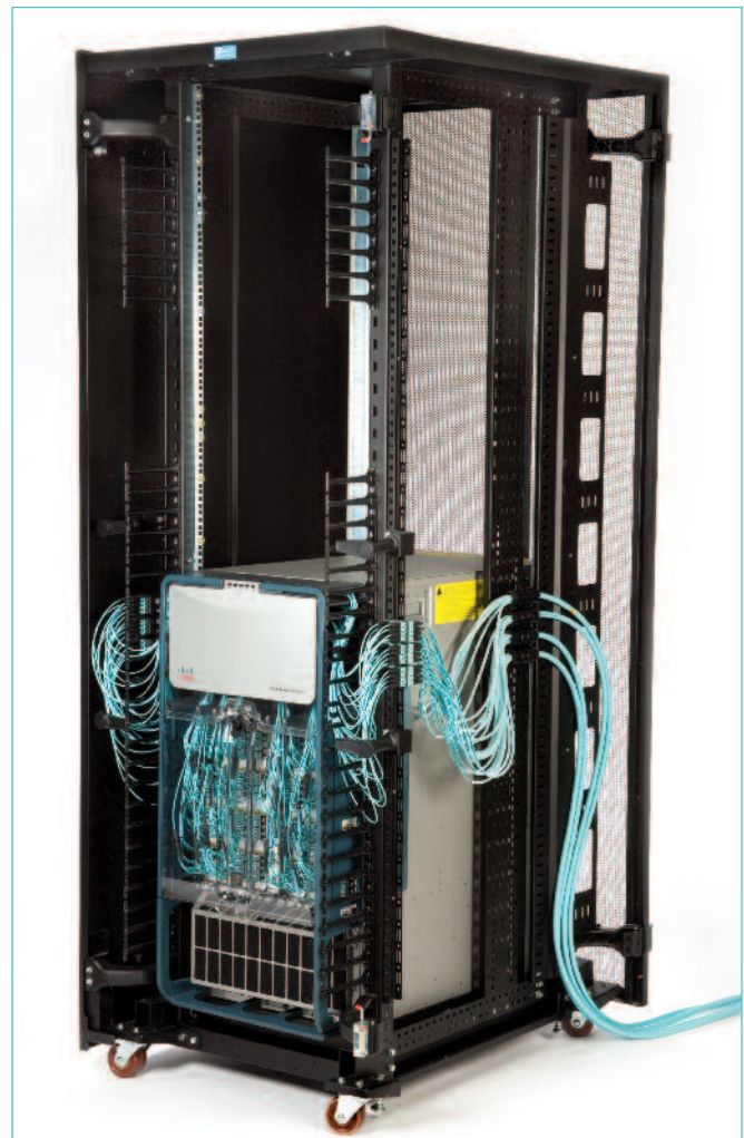
Sistema Zero-U para switch Ethernet Nexus 7010 de Cisco en un gabinete Teraframe™ de la serie N, de CPI | Foto LAN1621
